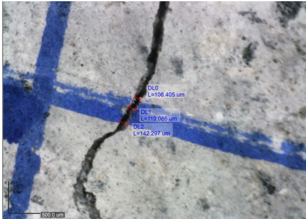
Figura 1. Vista de la fisura generada mediante el ensayo de tracción indirecta en el hormigón sostenible con cenizas de biomasa y áridos porosos de cenizas de carbón.
